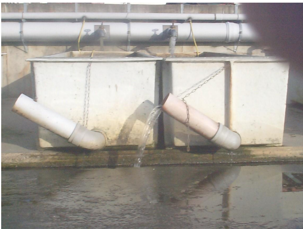
d.m.v. de "schuinte" van de afvoer kan het waterniveau worden ingesteld, d.m.v. de kraan boven het bekken de doorstroming.
