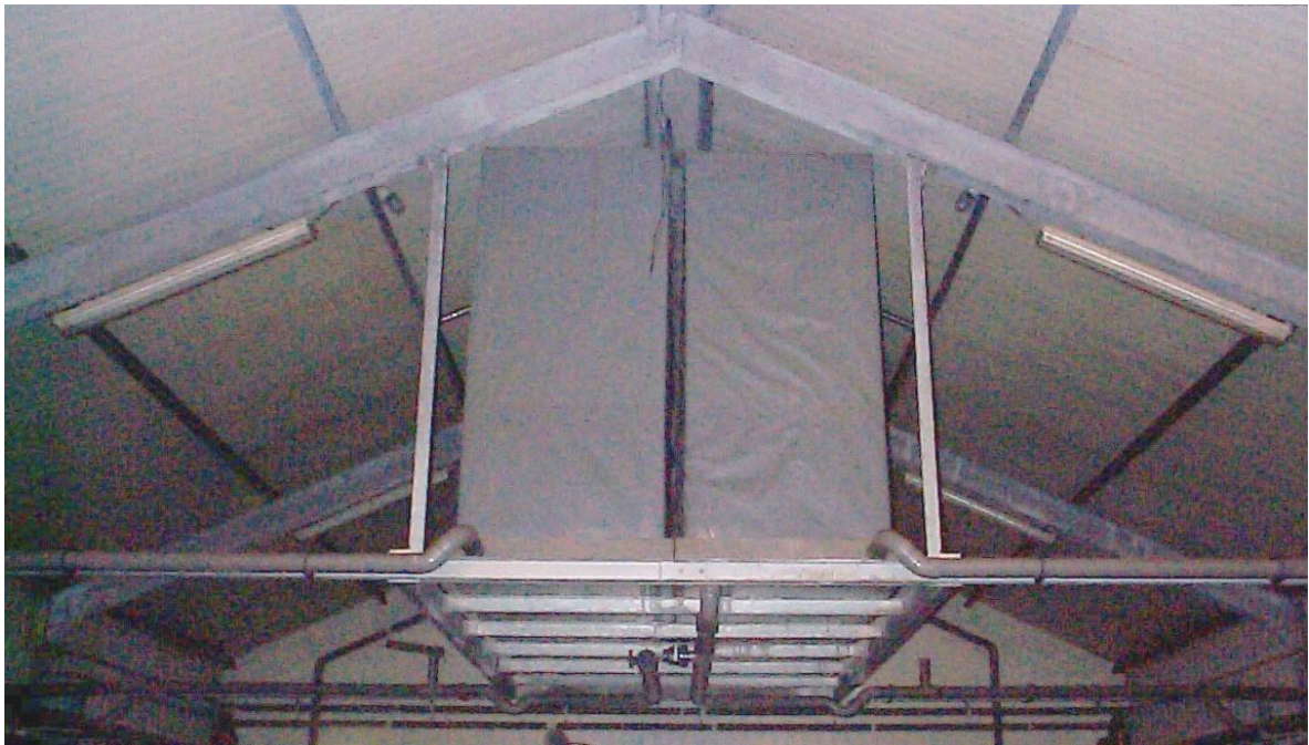
Twee filters met opvangbak in de nok van de broedhal.
